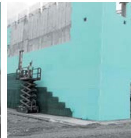
FIBRANxps MAESTRO en sandwich con el hormigón aún visible en la fase de construcción.
