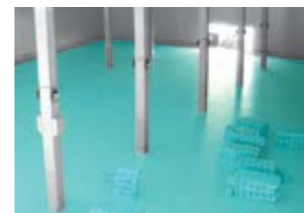
Aislamiento térmico de una sala de refrigeración con FIBRANxps 500-L y 700-L
